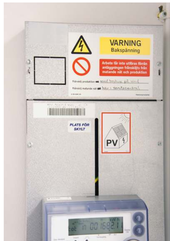
En solcellsanläggning ska förses med de varningsskyltar och den märkning som krävs. Foto: MSB
