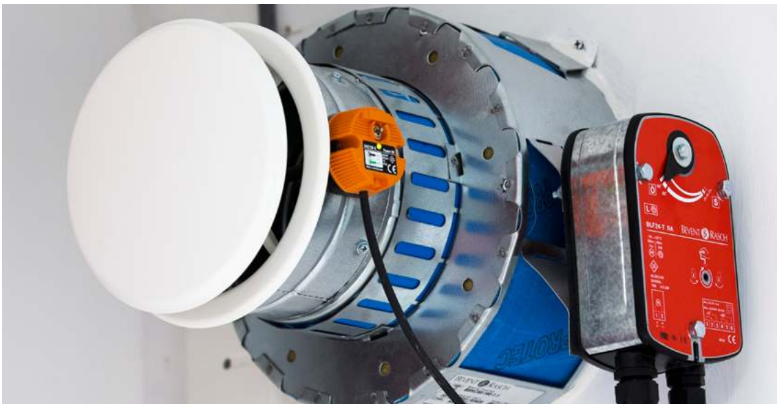
Brand-/brandgasspjäll kan vara en del av ventilationssystemets funktion vid brand, Rutiner för kontroll och skötsel behövs. Foto: Johan Eklund
