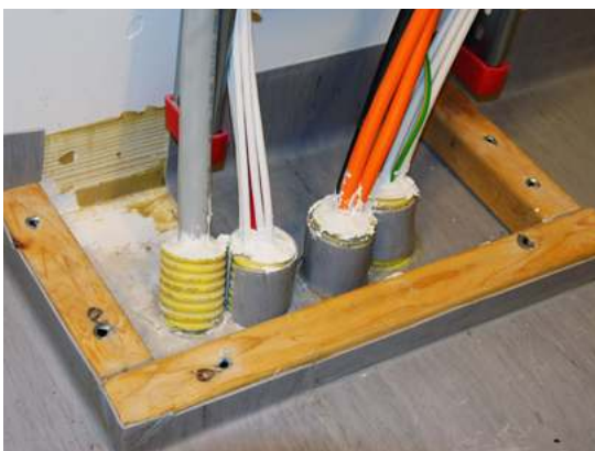
I en brandcellsgräns måste hål eller genomföringar för exempelvis ledningar eller rör brandtätas. Foto: MSB
