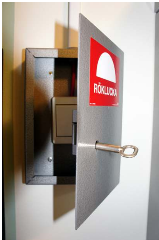
Vissa rökluckor kan öppnas med hjälp av en tryckknapp. Öppningsanordningen är oftast placerad vid entrén. Foto: MSB
