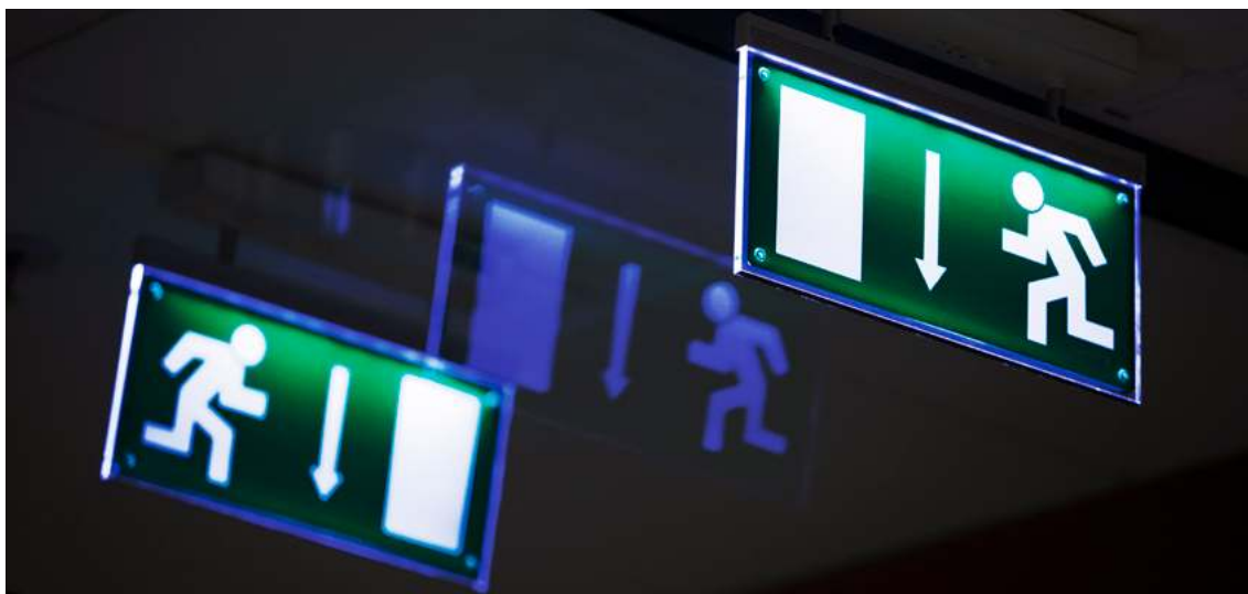
När det brinner får det inte uppstå tveksamheter kring var man kan ta sig ut. Svårorienterade utrymningsvägar i flerbostadshus ska vara markerade med utrymningsskyltar. Foto: Johan Eklund
