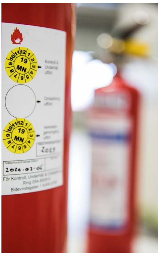
Visst underhåll av brandskyddet kan ordnas genom serviceavtal med en entreprenör. Foto: Pavel Koubek
